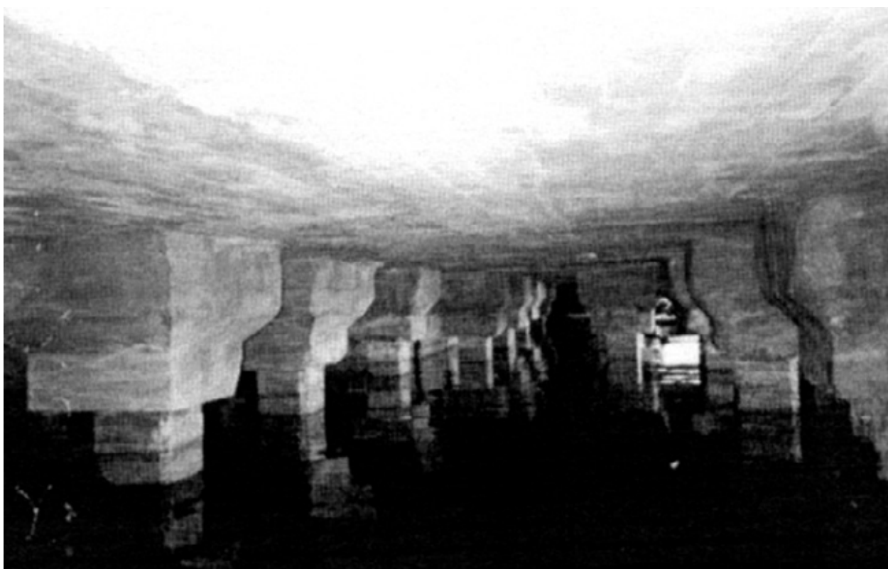
Рис. 4 – Внешний вид диагностируемого ростверка железобетонных причалов Николаевского морского порта
