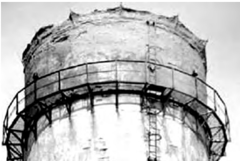
Рис. 4 – Коррозия бетона оголовка заводской дымоотводящей трубы вследствие конденсации агрессивных печных газов
